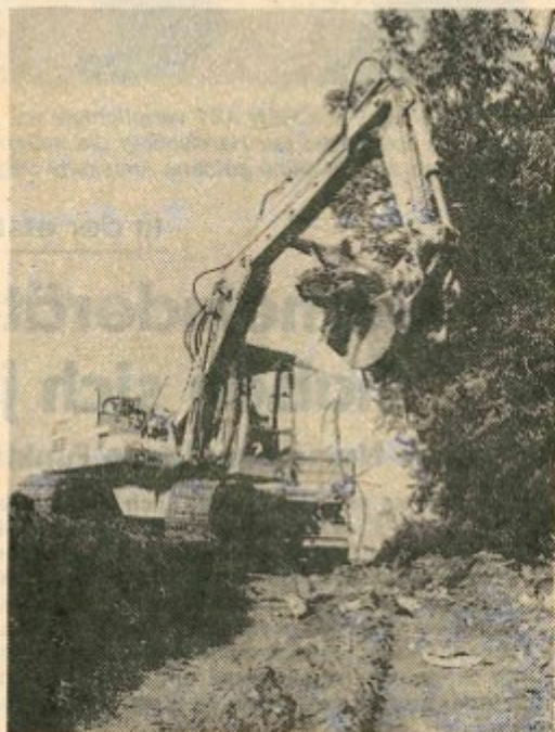
RANDVOLL ZUGESCHÜTTET haben unbekannte Umweltsünder die Batzenhofhohle zwischen Stupferich und Hohenwettersbach. Auf einer Länge von 400 Metern lagern dort meterhoch Herde und Wannen, Bauschutt und Zäune, Schrott-Pkws und stinkender Unrat, denen nun Bagger mit ihren Greifern zu Leibe rücken. Knapp 70 000 DM müssen investiert werden, um das flächenhafte Naturdenkmal neu erstehen zu lassen. Foto: Hamel
